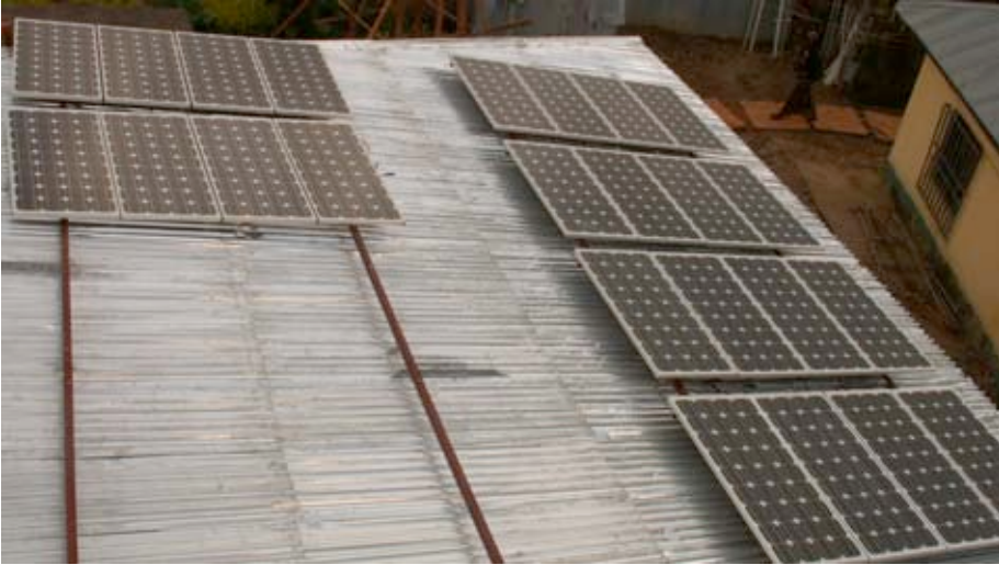
Figure 11.1: 24 panneaux solaires avec une puissance nominale de 80 W ont été montés sur le toit du NOC pour alimenter le système 24 / 7.
