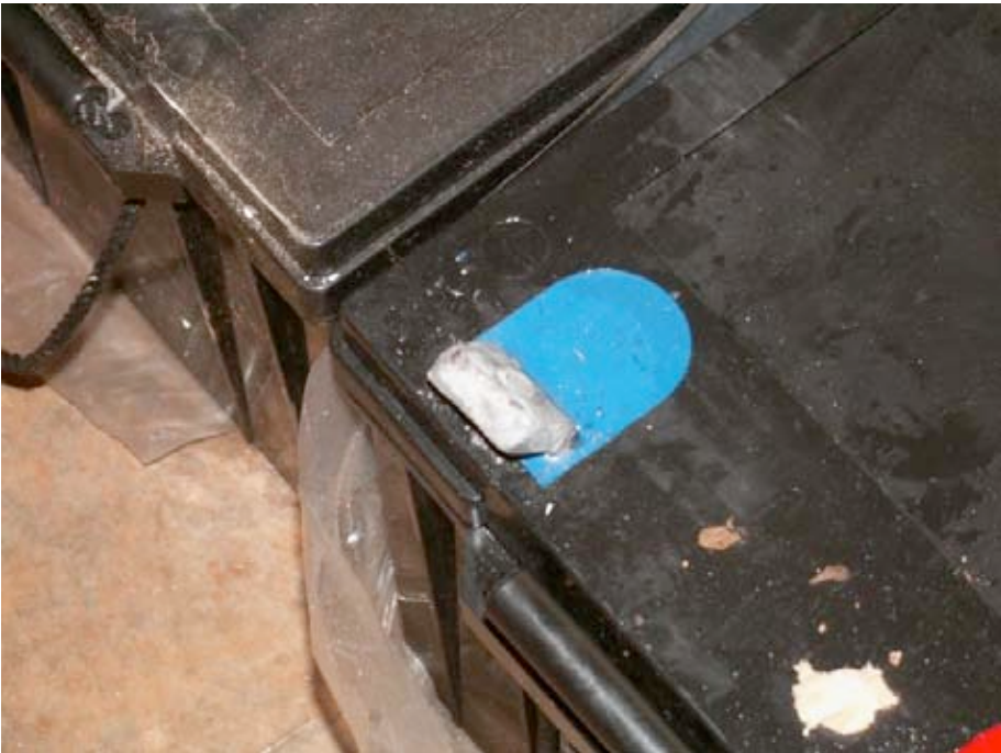
Figure 7.2 : Une batterie plomb-acide à 200 Ah. La borne négative a été cassée à cause d'une pression exercée sur les bornes lors du transport.
