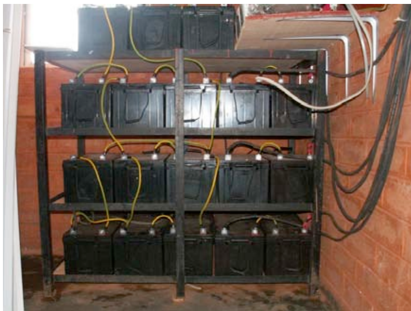
Figure 7.9 : Un banc de batteries à 3600Ah avec des courants atteignant des niveaux de 45 A pendant la charge.
